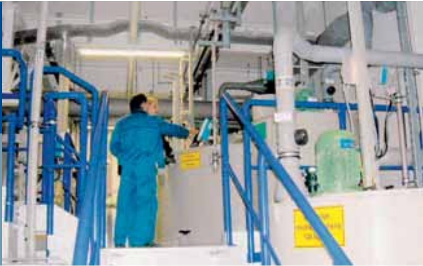
Teil der neuen Abwasser- behandlungsanlage der Sprinter-Lackierung
