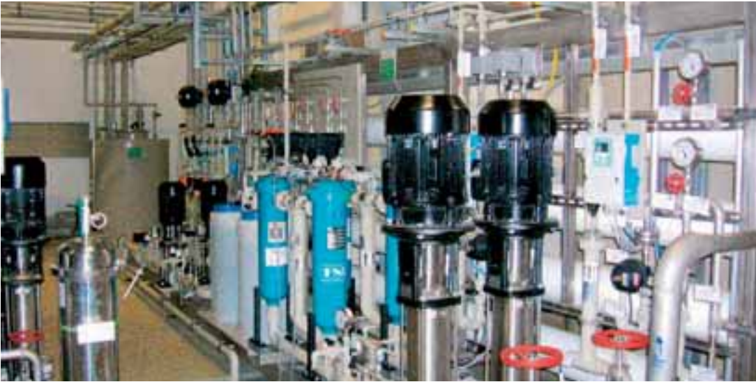
In der Wasseraufbereitungsanlage wird das vollentsalzte Wasser für den Eigenbedarf erzeugt.
